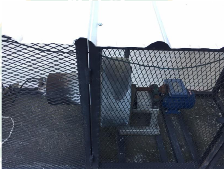
ภาพที่ 27 เครื่องเป่าลม
