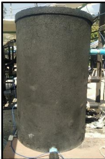
ภาพที่ 21 ถังเก็บน้ำร้อน
