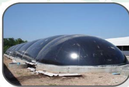
ภาพที่ 5 ระบบยูเอสบี (UASB: Up flow Anaerobic Sludge Blanket)
