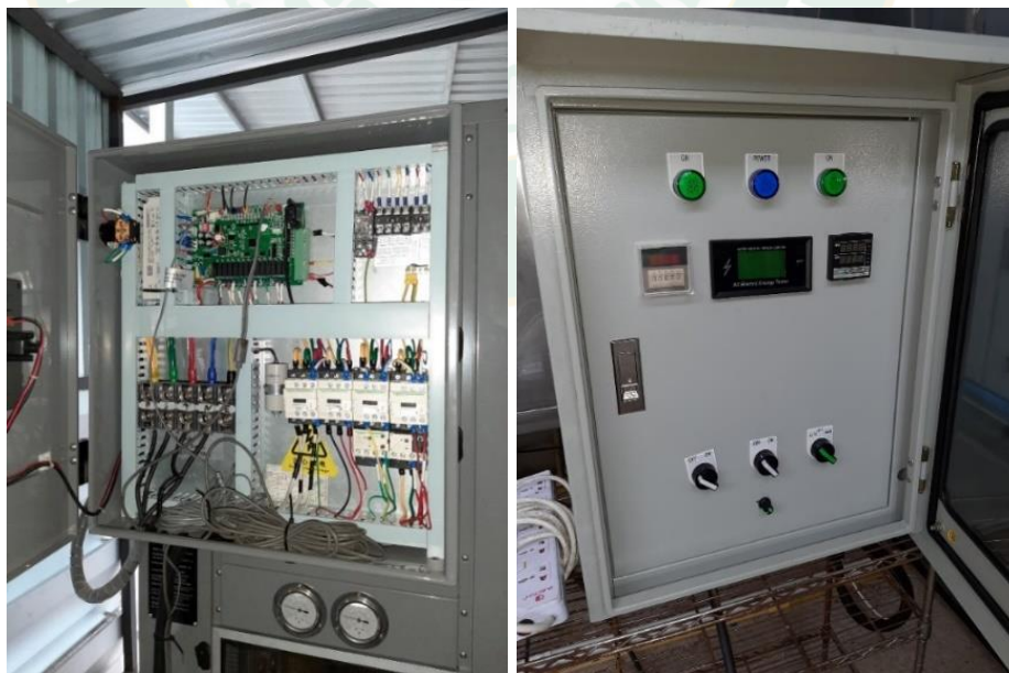
ภาพที่ 22 ก.) อุปกรณ์ควบคุมอุณหภูมิ, ข.) อุปกรณ์ตรวจวัดการใช้พลังงาน
