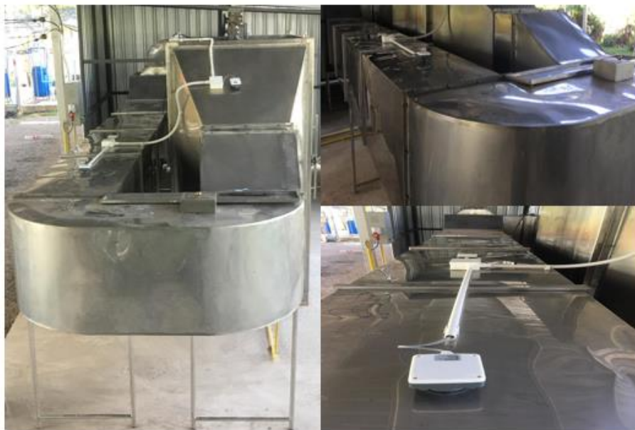
ภาพที่ 19 ระบบท่อหมุนเวียนลมร้อน
