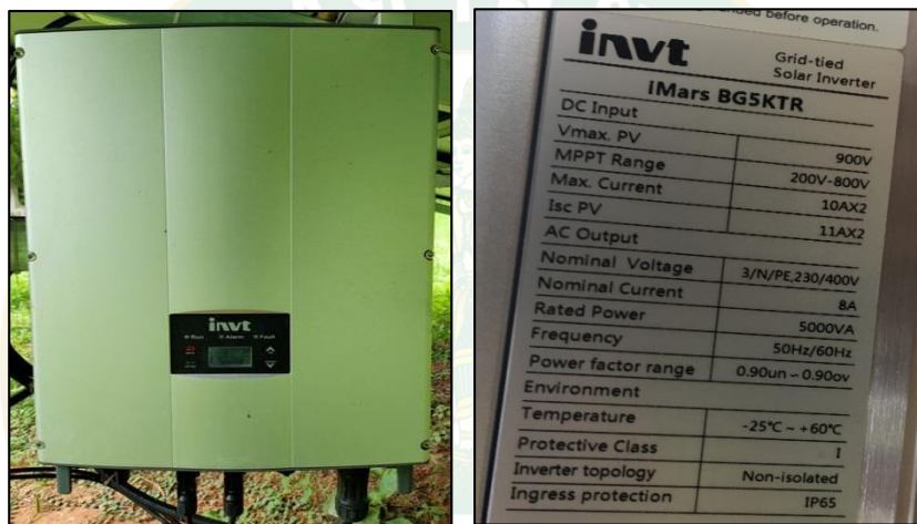
(ก) อินเวอร์เตอร์ที่ต่อเข้ากับระบบผลิตไฟฟ้าเซลล์แสงอาทิตย์
