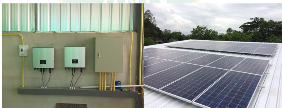
ภาพที่ 2 ระบบผลิตไฟฟ้าพลังงานแสงอาทิตย์
