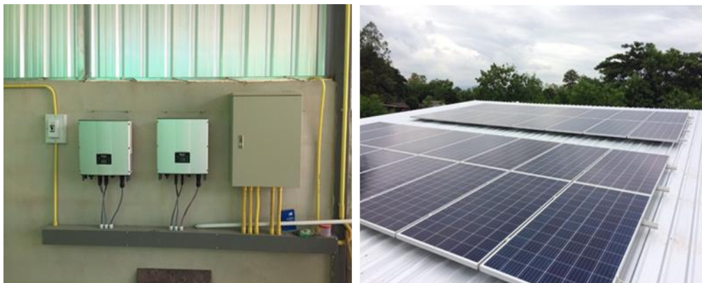
ภาพที่ 8 ระบบผลิตไฟฟ้าพลังงานแสงอาทิตย์ขนาด 11 กิโลวัตต์
