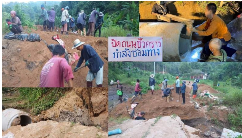
ภาพที่ 34 การพังทลายของถนนดิน
