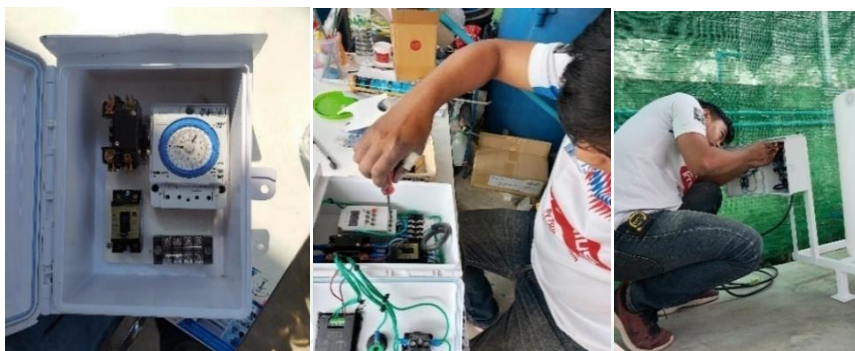
(ก) การวางตำแหน่งอุปกรณ์ (ข) การประกอบตู้คอนโทรลไฟฟ้า (ค) ติดตั้งตู้คอนโทรลไฟฟ้า
