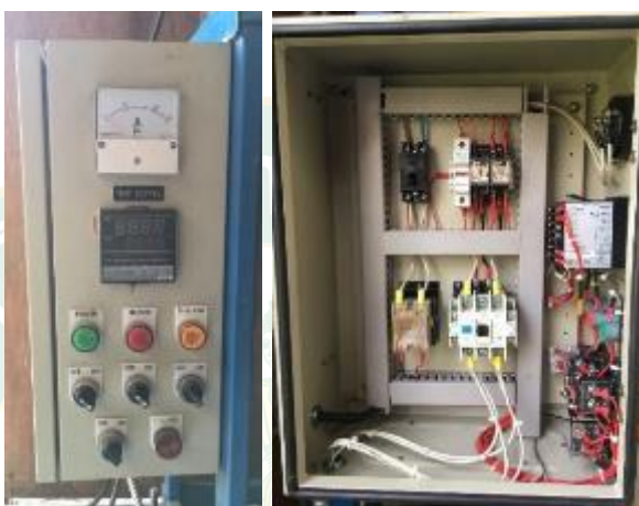
ภาพที่ 14 ชุดควบคุมอุณหภูมิภายในห้องเผาไหม้
