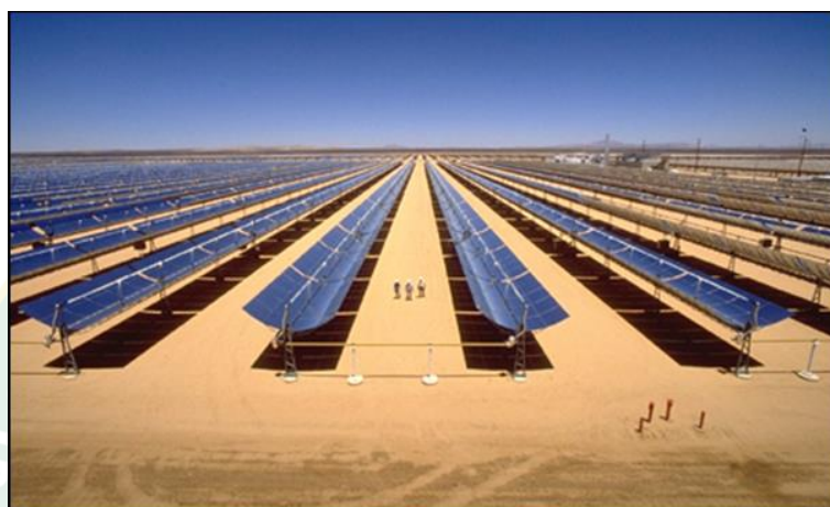
ภาพที่ 8 ระบบรางพาราโบล่า (Parabolic Through)
