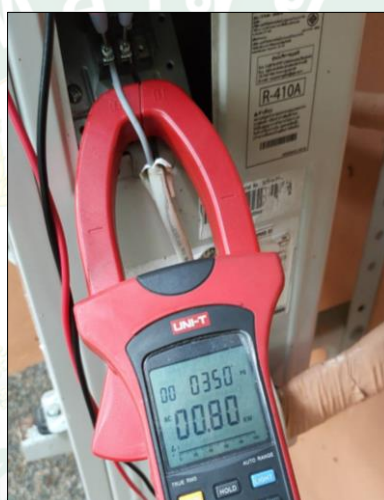
ภาพที่ 56 การตรวจวัดกำลังไฟฟ้าเครื่องอัดไอ
