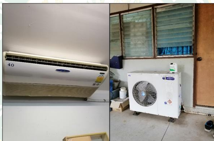
ภาพที่ 80 ลักษณะเครื่องปรับอากาศแบบแยกส่วน (Split Type) ภายในฟาร์มภายในคณะสัตวศาสตร์และเทคโนโลยี
