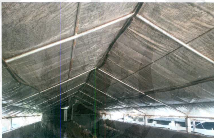
ภาพที่ 19 การติดตั้งระบบน้ำภายในโรงเรือนเพื่อเพิ่มความชื้นและลดอุณหภูมิภายในโรงเรือน ในจังหวัดขอนแก่น
