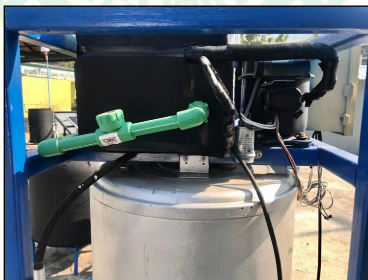
ภาพที่ 34 ถังน้ำที่ส่วนระเหยของปั๊มความร้อน
