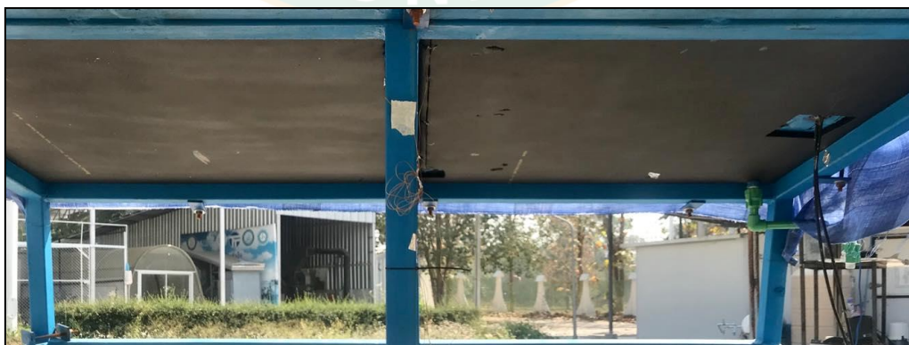
ภาพที่ 30 กล่องน้ำระบายความร้อนติดตั้งใต้แผงเซลล์แสงอาทิตย์
