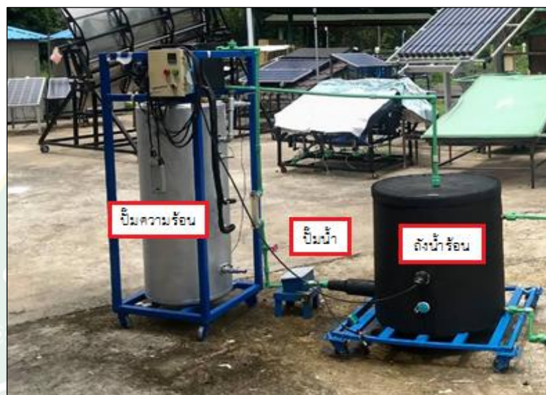
ภาพที่ 47 ระบบปั๊มความร้อนที่ใช้ในการทดสอบ
