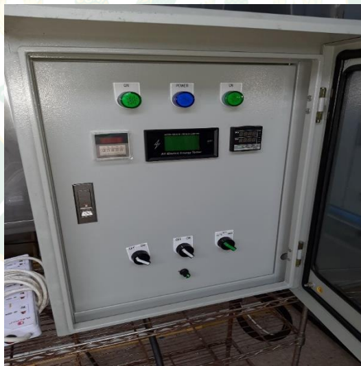
ภาพที่ 53 อุปกรณ์ตรวจวัดการใช้พลังงาน
