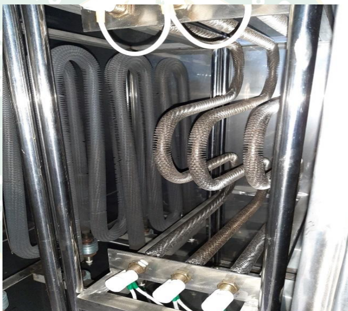
ภาพที่ 22 ฮีตเตอร์ไฟฟ้าขนาดกำลังไฟฟ้าจ่าย (Power input) รวม 14.5 kW
