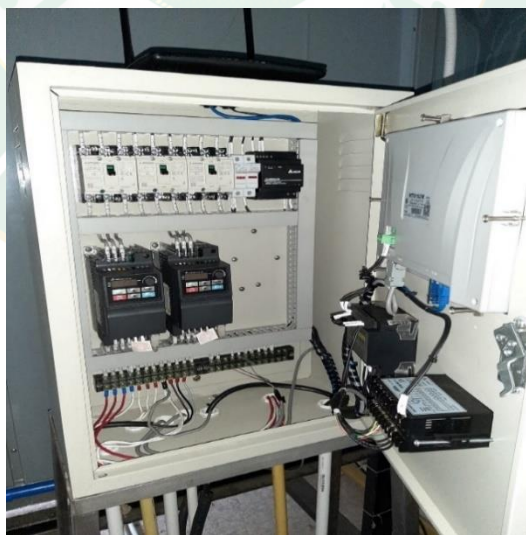
ภาพที่ 51 ชุดอุปกรณ์ควบคุมความเร็วรอบมอเตอร์หมุนถาดอบแห้ง และพัดลมหมุนเวียนอากาศ
