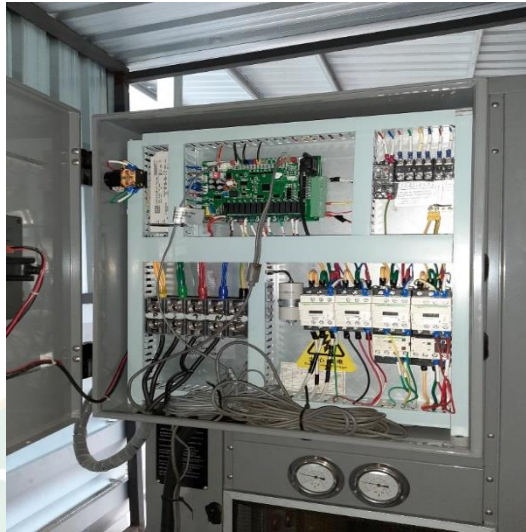
ภาพที่ 52 ชุดอุปกรณ์ควบคุมอุณหภูมิ
