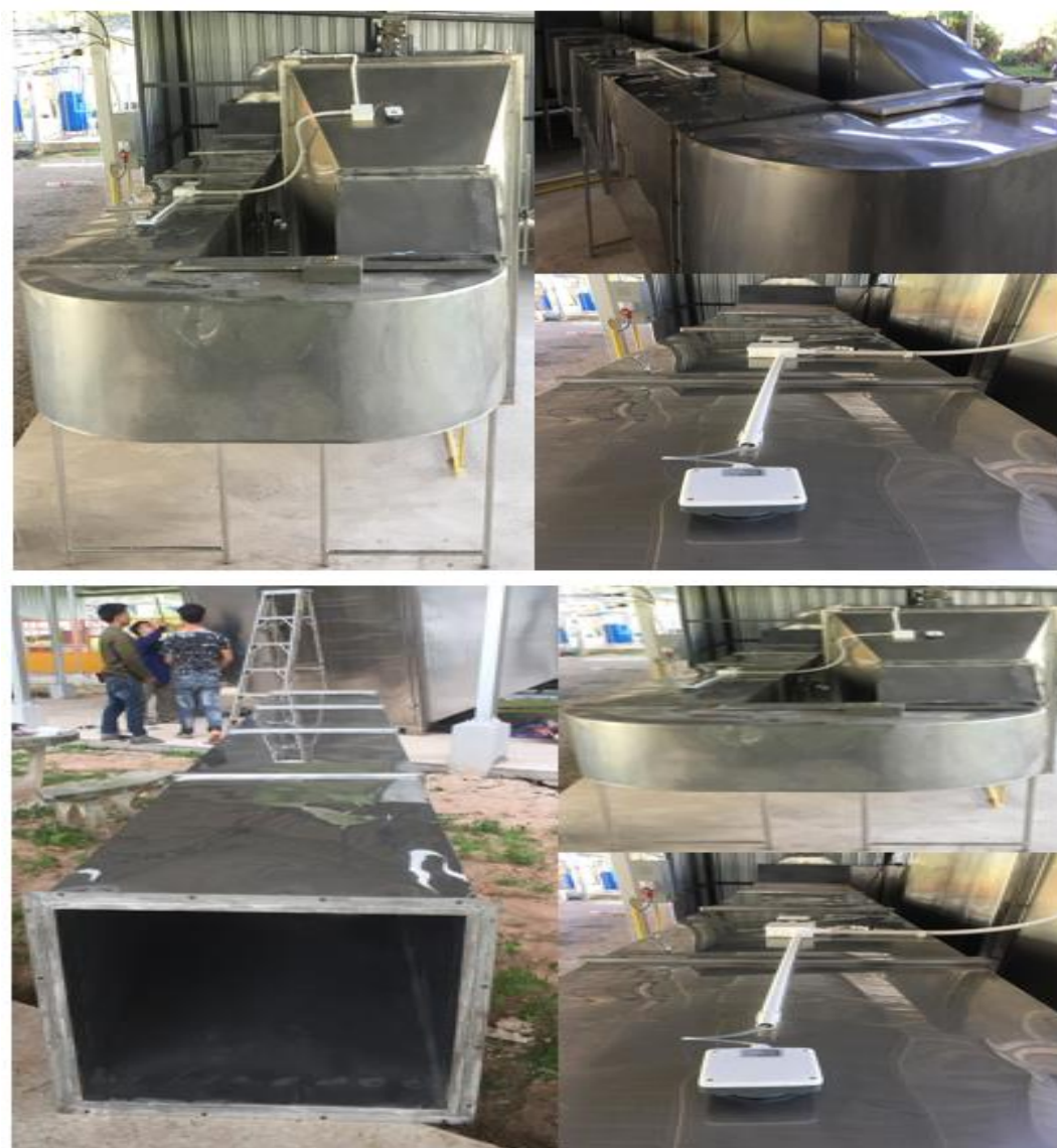
ภาพที่ 24 ระบบท่อหมุนเวียนลมร้อน
