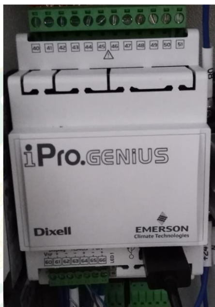
ภาพที่ 38 พีแอลซีควบคุมของระบบทำความเย็นแบบดูดกลืน
