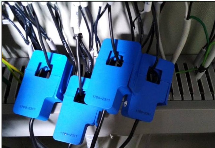
ภาพที่ 30 อุปกรณ์ตรวจวัดกระแสไฟฟ้าของอุปกรณ์ไฟฟ้าในระบบ
